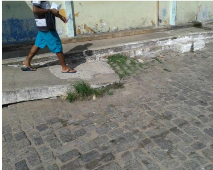
Figura 29 – Pavimento e rampa de acesso inadequado para PNE na policlínica Cidade Esperança
